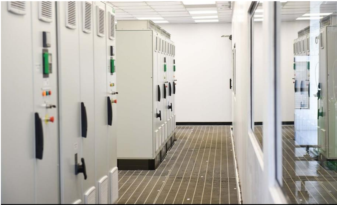
Ilustración 4: Paneles Eléctricos, Sistema Barrera de Salinidad
